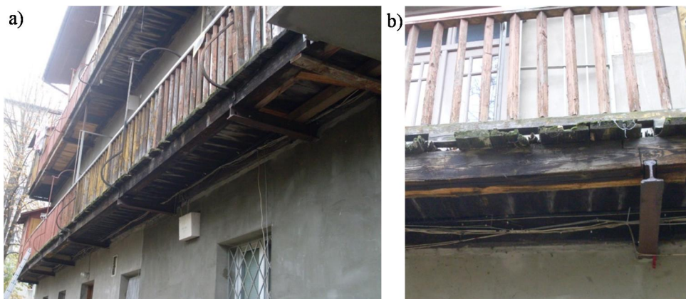
Fot. 1. Konstrukcja i stan techniczny galerii wspornikowych o konstrukcji stalowo-drewnianej (G1): a) widok na galerię i ich stan techniczny, b) uszkodzenia konstrukcji drewnianej i desek podestu.
