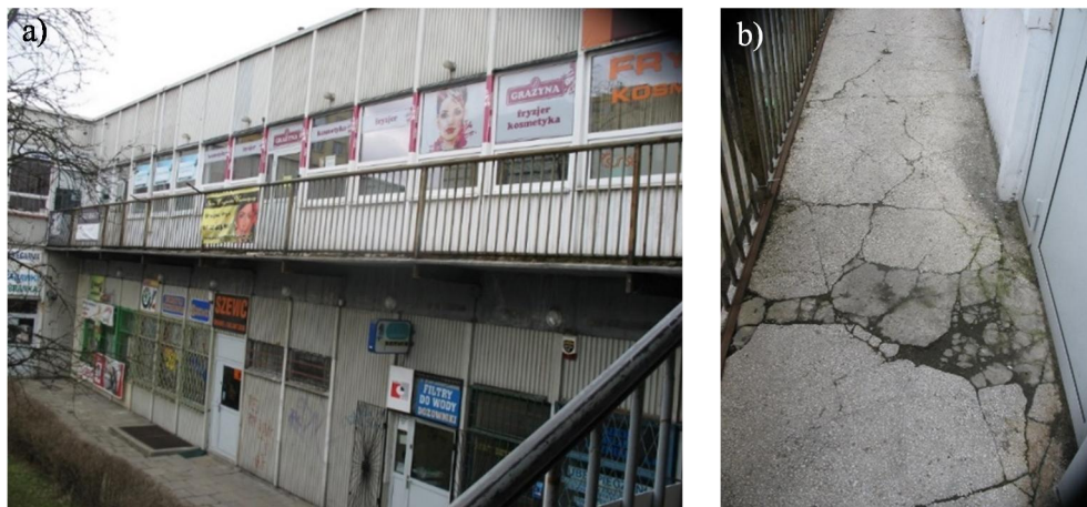
Fot. 2. Konstrukcja i stan techniczny galerii wspornikowej o konstrukcji stalowo-żelbetowej (G2): a) widok na galerię i jej stan techniczny, b) zdegradowana warstwa posadzki z lastryka.
