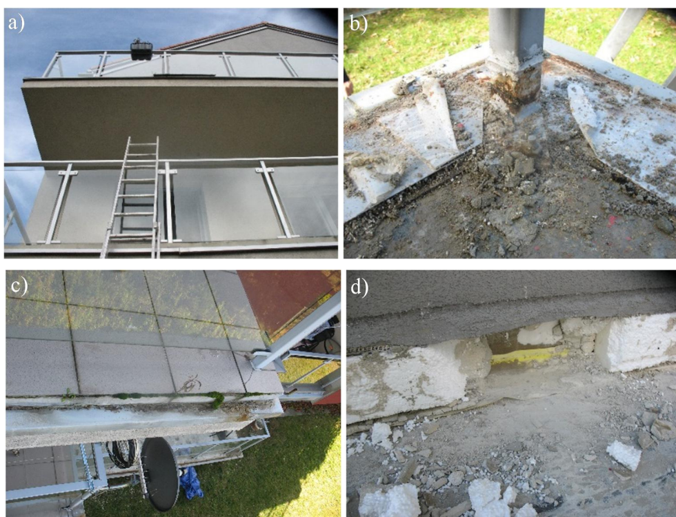
Rys. 5. Uszkodzenia balkonów (B3): a) odpadające czoło balkonu, b) wadliwie zamontowane obróbki blacharskie, korozja słupka balustrady stalowej, c) uszkodzenia płytek i czoła balkonu, d) niewłaściwie uszczelnione połączenie płyty balkonowej ze ścianą budynku.
