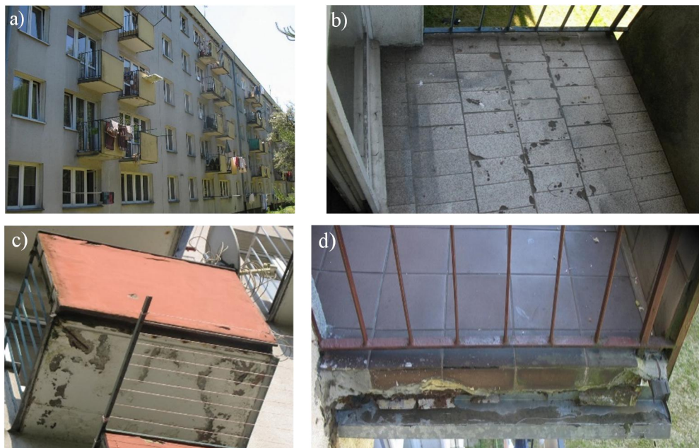
Fot. 4. Typowe uszkodzenia prefabrykowanych balkonów żelbetowych (B2): a) widok ogólny, b) uszkodzenia posadzki z płytek, c) uszkodzenia żelbetowej płyty balkonu (widok od dołu) i balustrady, d) niewłaściwie wykonane i zamocowane obróbki blacharskiej na krawędziach bocznych (obróbki zdeformowane).
