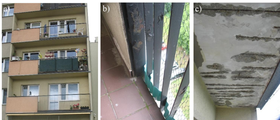
Fot. 3. Balkony (loggie) w budynku mieszkalnym o konstrukcji prefabrykowanej: a) widok ogólny, b) korozja balustrad stalowych i odspojenie warstw na prefabrykacie, c) odspojenie otuliny i korozja zbrojenia płyty (widok po usunięciu wtórnych wypraw tynkarskich).
